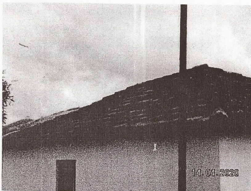
Foto 04 – Detalhe externo da cobertura com destaque para o telhamento irregular, inclusive com flambagem do engradamento
