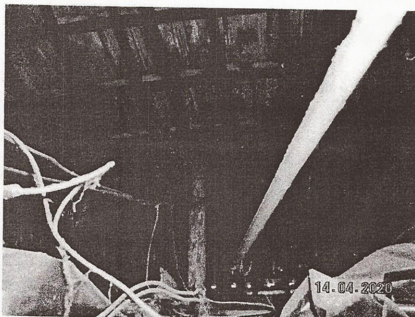
Foto 06 – Detalhe da instalação elétrica existente executada de forma precária
